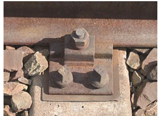
Een schroefverbinding van een spoorstaaf en een dwarsliggers
